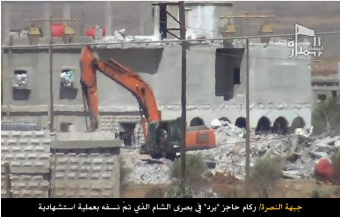
[صورة: ركام المبنى المُدمر]
